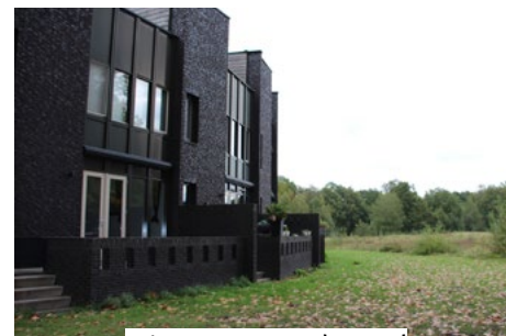
ruig gras tot aan de gevel
